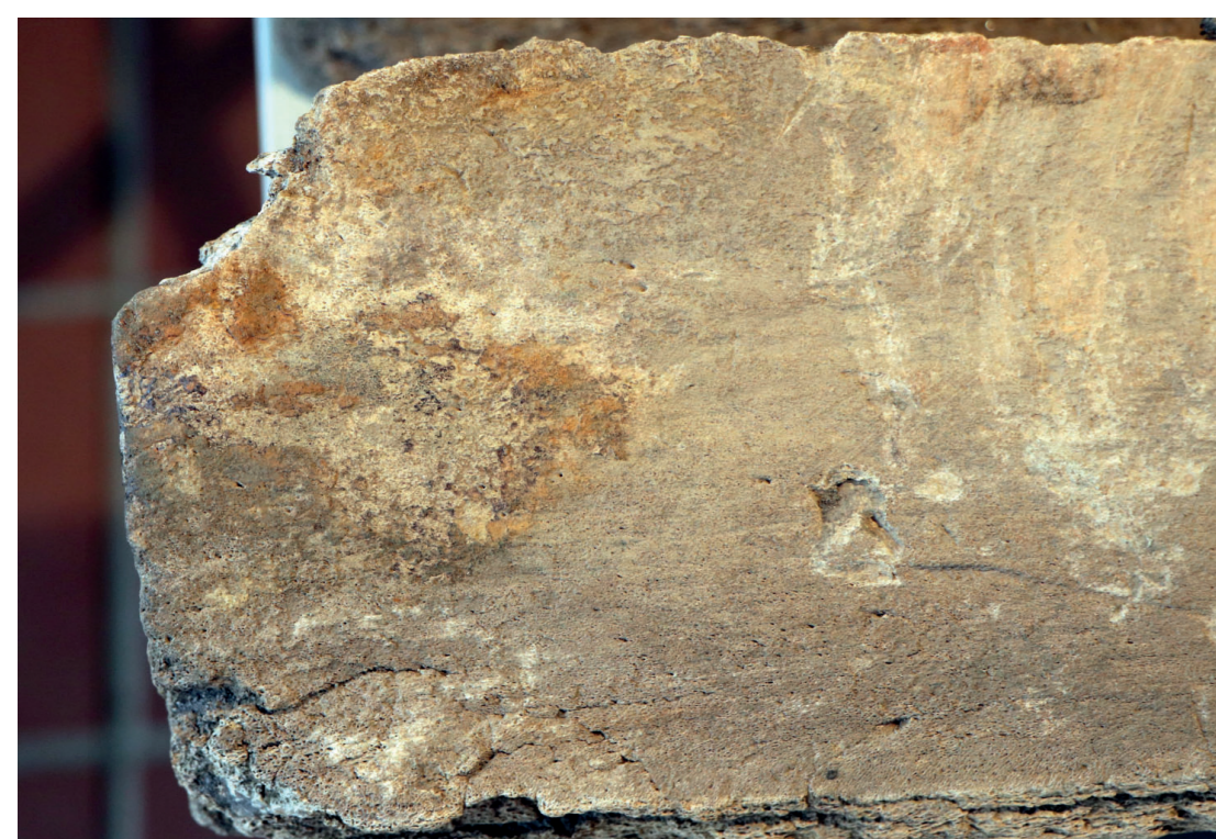
Abb. 8: Rostspuren einer eisernen Abdeckung an der Oberkante eines Pfostens. Foto Vitali Friesen 29. 3. 2023
